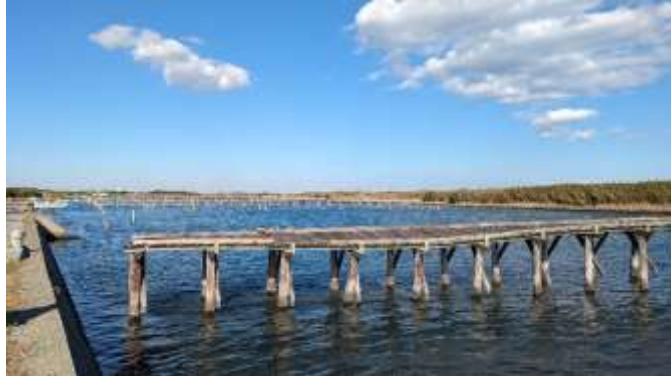
川に架かる廃橋となった木橋
