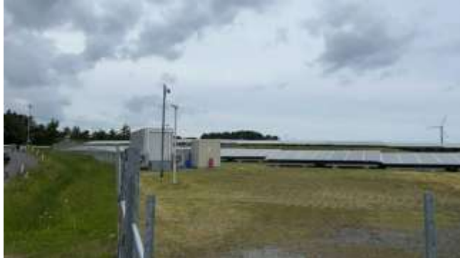
太陽光発電施設
